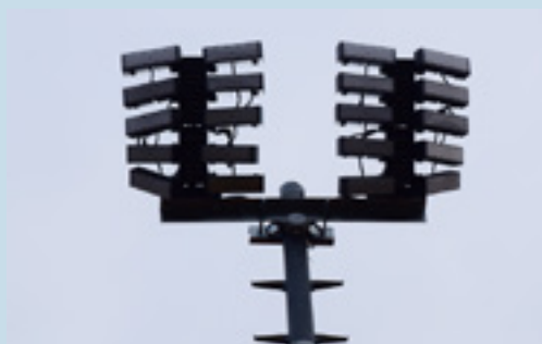
Neue Flutlichtanlage mit neuer LED-Beleuchtung
